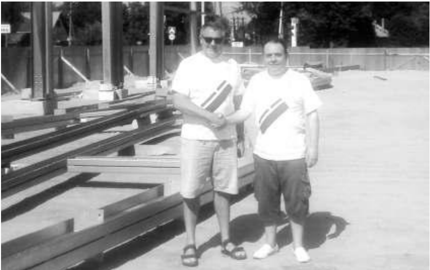
Владимир Клубков (слева) и Игорь Витюк на строительстве народно-хозяйственного объекта в Пушкинском районе Подмосковья, которым руководит В.Клубков, 2014 г.
